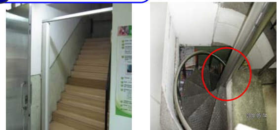
醫院樓梯被隱蔽且寬度不足
