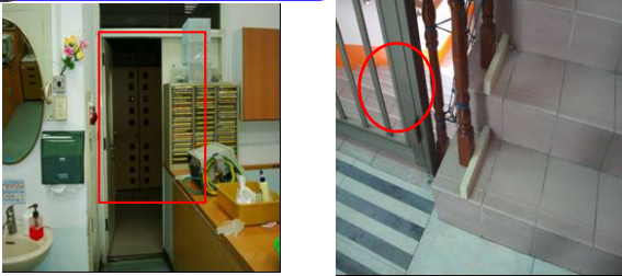
醫院通往直通樓梯加出入口且寬度不足
